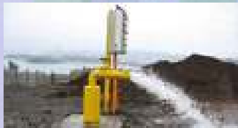
En Fuente de Aguas Subterránea
